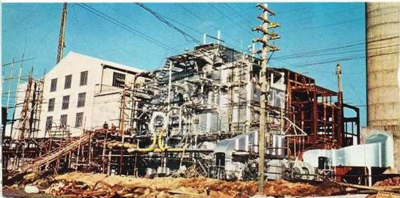
自家発電設備及び貯留設備
