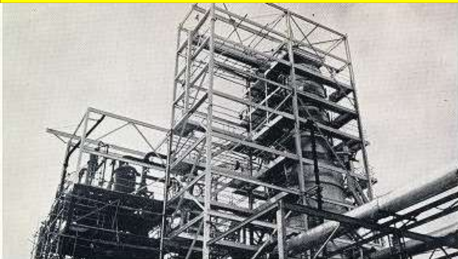
減圧蒸留装置
